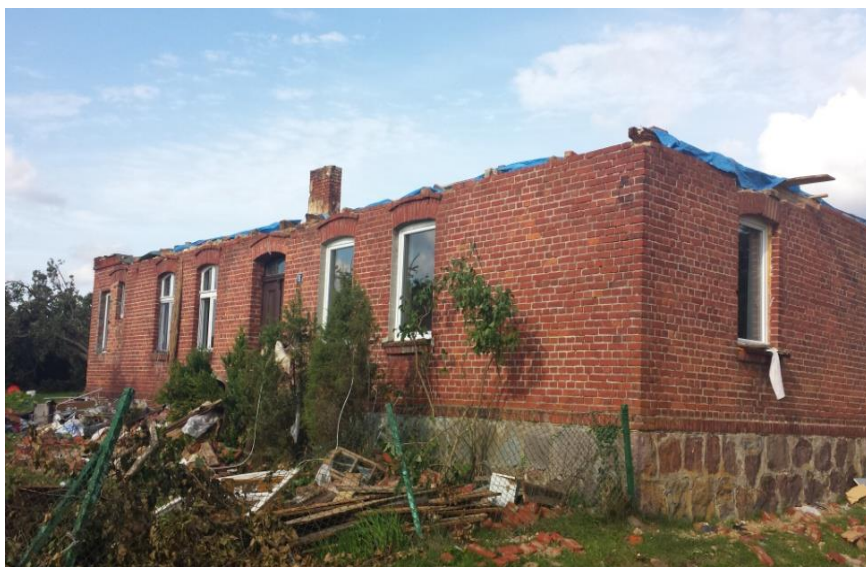
Wielkie szkody poniesione w mieniu materialnym.
