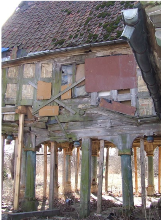
24. Dom podcieniowy w Orłowie w ruinie
