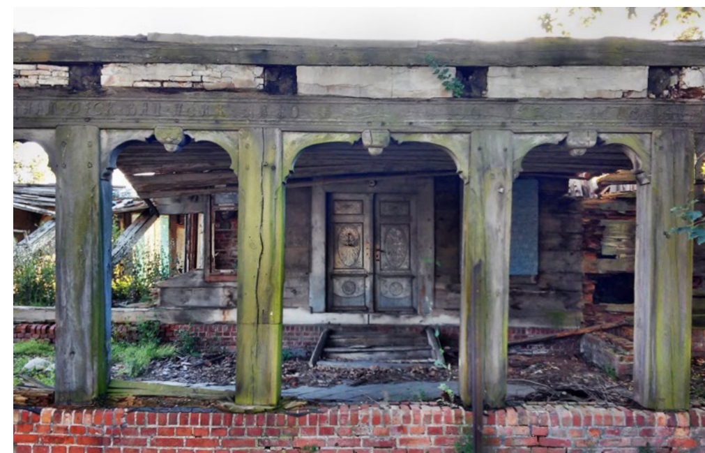
20. Ruina domu podcieniowego zbudowanego przez P. Loewena w Lasowicach Małych
